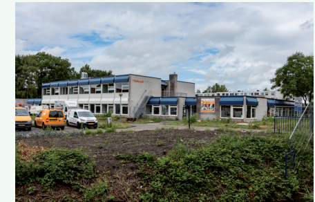
Het voormalige gebouw van het Vitalis College aan de Nieuw Inslag wordt momenteel gerenoveerd ten behoeve van de scholencluster Christoffel.
